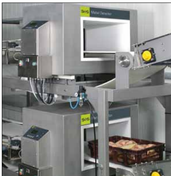
Détecteurs de métaux GLS montés sur deux lignes de production pour analyser des volailles
